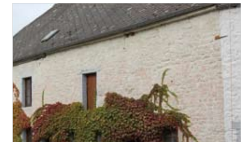
Facade badigeonnée à Matagne-la-Grande
